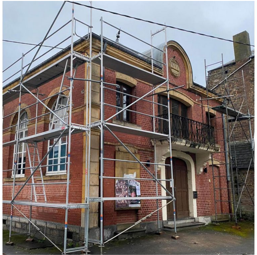
L'échafaudage a été posé sur la façade de la salle Bernard-Maillard, prémices à la rénovation de la toiture prévue « ces prochaines semaines ». MD.
